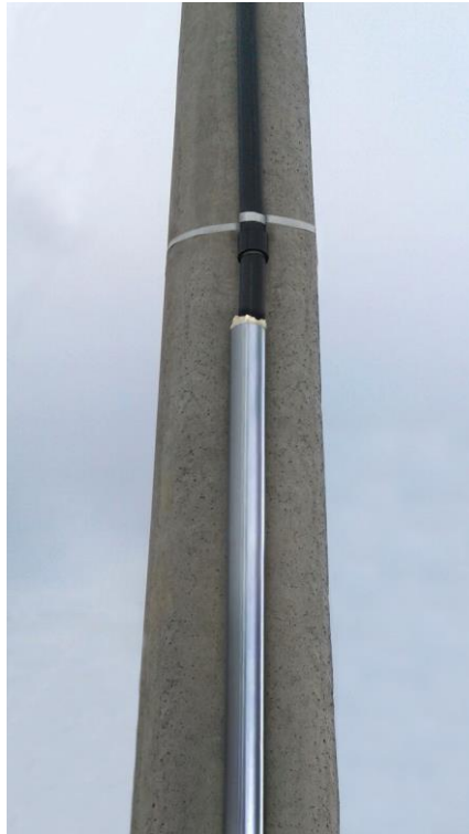
Foto ilustrativa 01 dos anexos D, E, H e I – Detalhe do eletroduto junto ao poste
