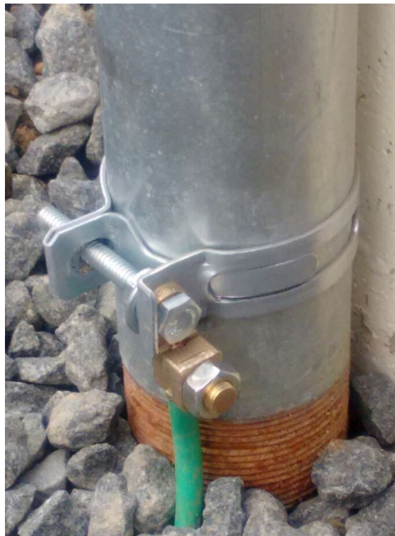
Foto ilustrativa 03 dos anexos G e H – Detalhe da abraçadeira de com terminal para aterramento
