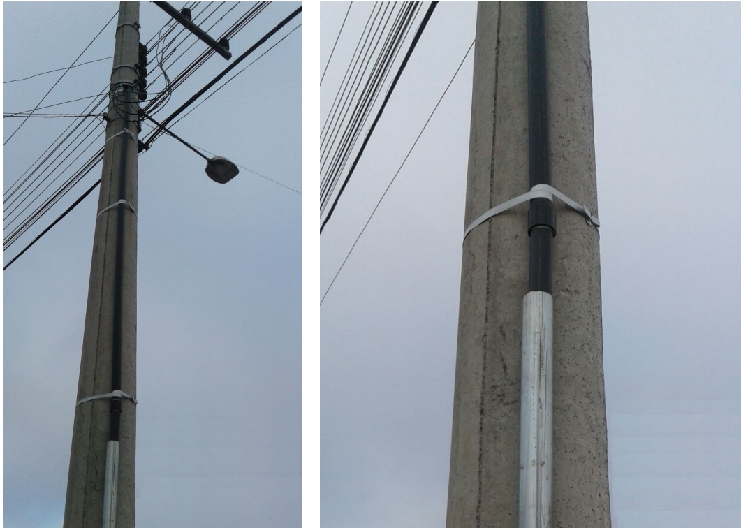
Fotos ilustrativas 01 e 02 dos anexos G e H – Detalhe do eletroduto junto ao poste
